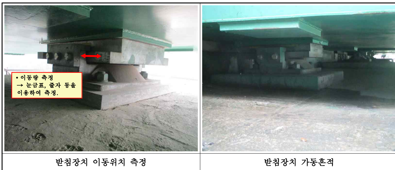
【표 3-33】 춘천방향 - 교량받침 가동상태 검토결과
